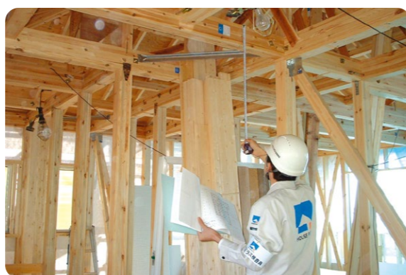
躯体工事の完了時に、主に建物骨組の構成、構造部材の規格、部材の接合部の状態、耐久性向上のための対策などを確認します。
