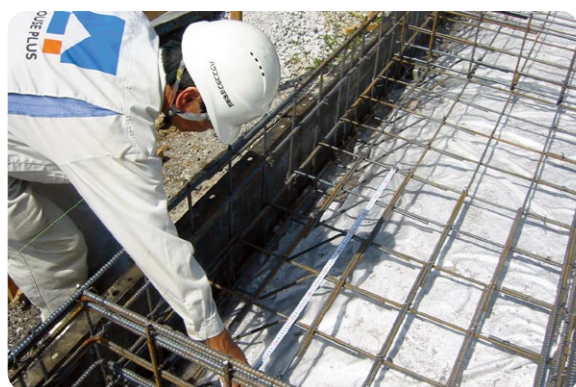
基礎の配筋工事の完了時に、基礎配筋の施工状況等を確認します。
