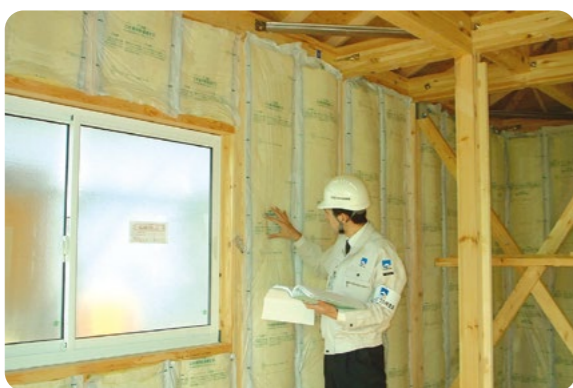
内装下地張り直前の段階に、主に竣工時に隠蔽される外壁等の構造、各部の断熱構造など確認します。
